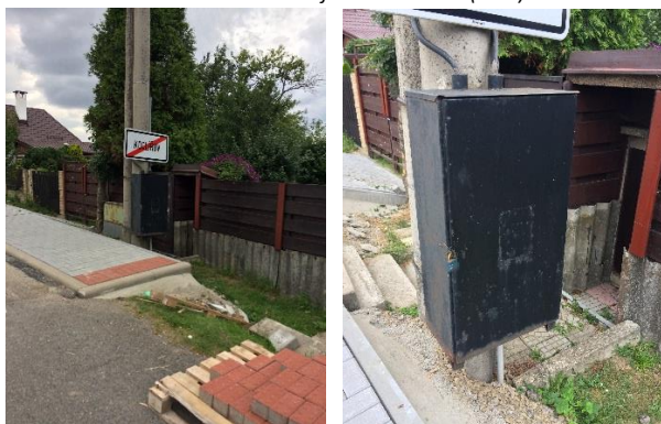
Obrázek č. 2.1.1.1: Rozvaděč veřejného osvětlení (RVO)
