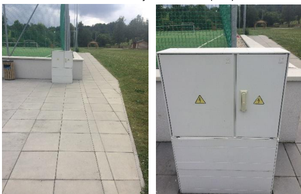
Obrázek č. 2.1.1.6: Rozvaděč veřejného osvětlení (RVO)
