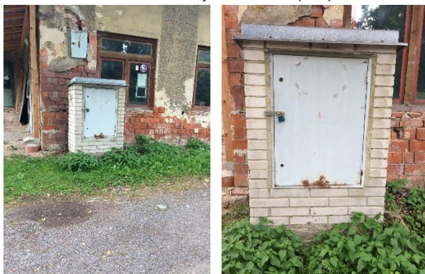
Obrázek č. 2.1.1.3: Rozvaděč veřejného osvětlení (RVO)
