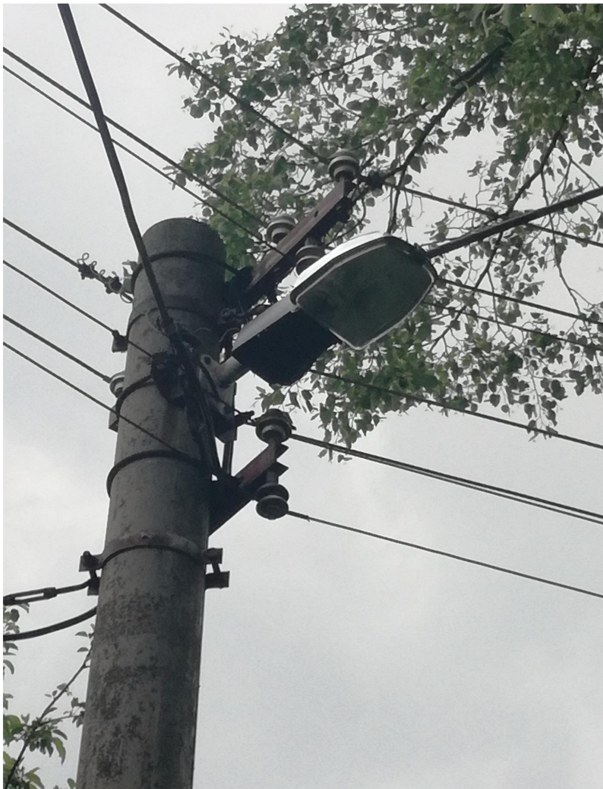
Foto 4: Stávající osvětlení, VM elektro - 70 VS
