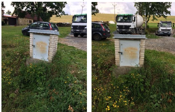
Obrázek č. 2.1.1.5: Rozvaděč veřejného osvětlení (RVO)
