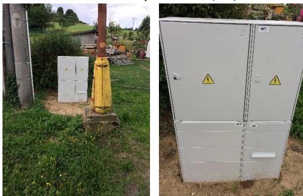
Obrázek č. 2.1.1.4: Rozvaděč veřejného osvětlení (RVO)
