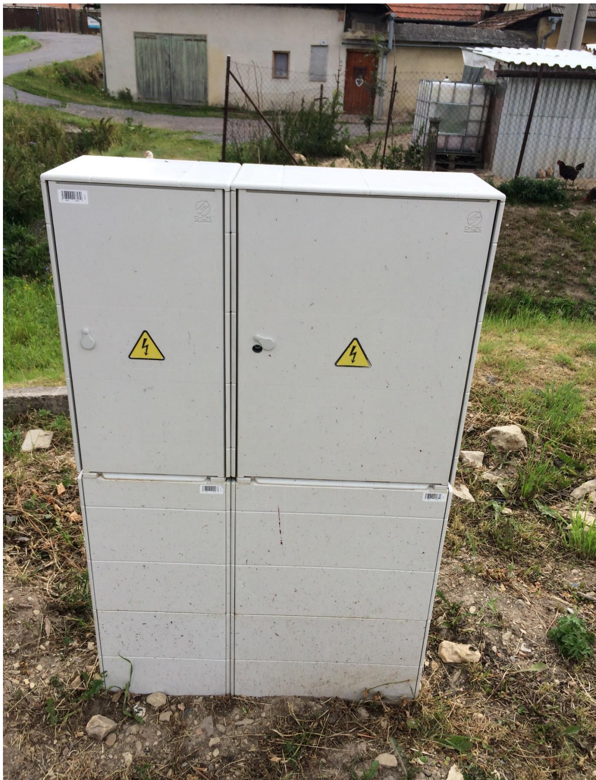
Foto 2: Rozvaděč veřejného osvětlení
