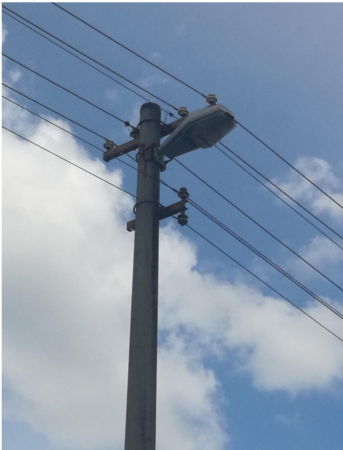
Foto 3: Stávající osvětlení, Elektrosvit - Ramínko
