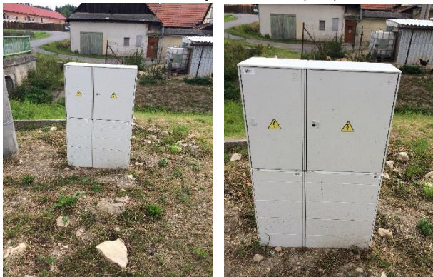
Obrázek č. 2.1.1.2: Rozvaděč veřejného osvětlení (RVO)
